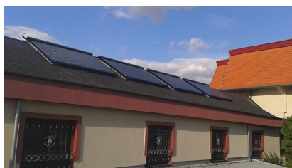
Salón v Bratislave - ohrev TÚV a podpora vykurovania
